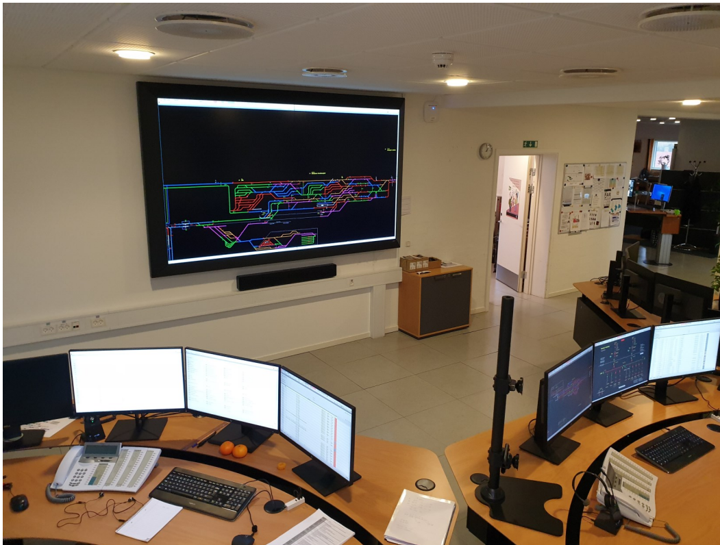
Kørestrøm på fjernbanen.
